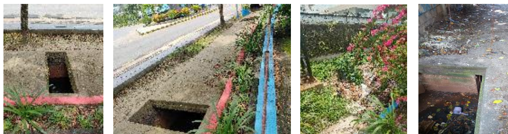
Gambar 4. Kondisi riol kota yang terbuka dan yang tertutup tanaman &
