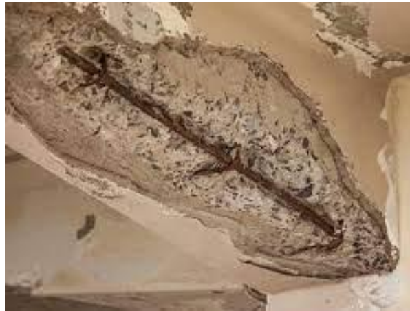
Gambar 1. Spalling pada beton akibat lingkungan korosif
